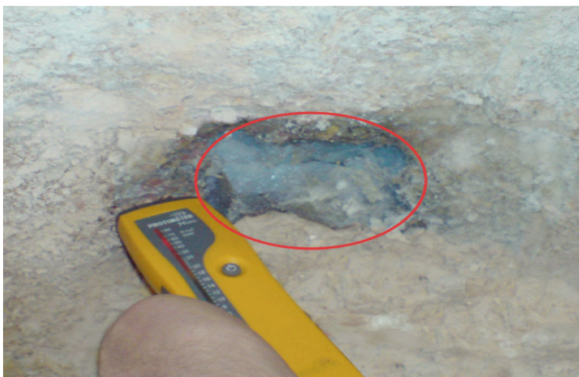
Odkrytá část zdi s dutinou obsahující ztuhlý gel vodního skla (v červeném oválu). Okolí je viditelně pokryto masivními výkvěty solí. Gel i soli na sebe váží vodu. Přiložený měřák obsahu vlhkosti jasně ukazuje nejvyšší stupeň vlhkosti – maximální hodnoty v červené oblasti měření.
